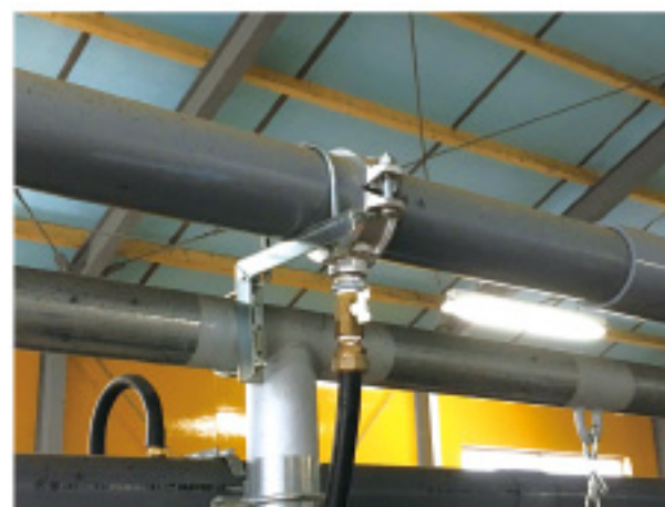
写真2 吐水量確保のために配管を太くした事例
